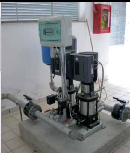
LA SOTTOCENTRALE PER UTA e per l'alimentazione del pavimento radiante dei servizi generali: le pompe sono state installate a collettore di distribuzione del fluido, con l'adozione, a monte, di una valvola miscelatrice al fine di consentire al circolatore di lavorare a pressione costante col variare del carico termico richiesto e della portata.
