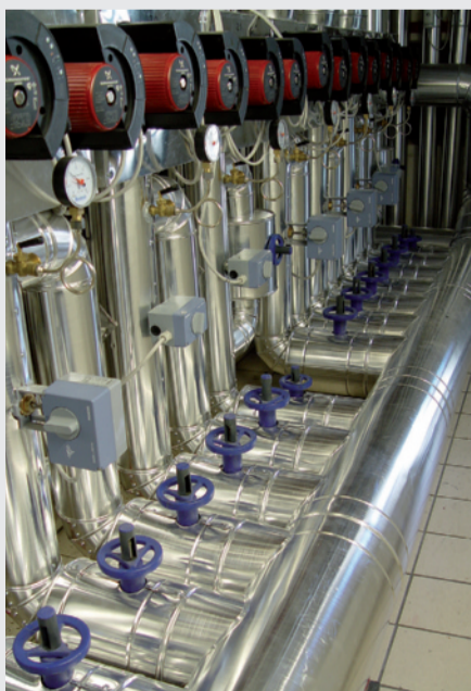
LA SOTTOCENTRALE per l'alimentazione del pavimento radiante della palazzina B: in primo piano i circolatori e le pompe miscelatrici.
