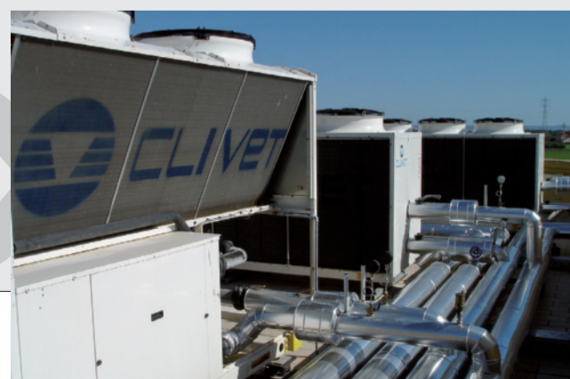
VISTA PARZIALE della centrale termofrigida.
