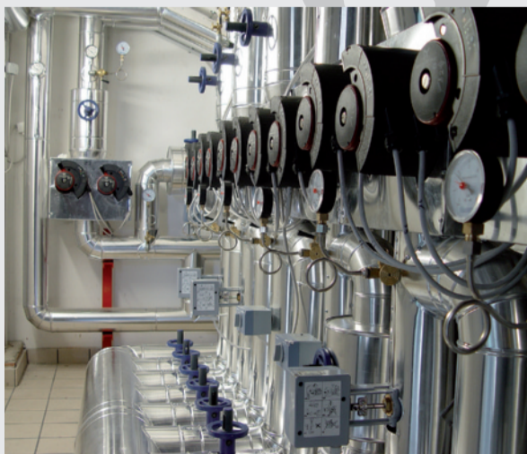
LA SOTTOCENTRALE per l'alimentazione del pavimento radiante delle palazzine B e C.
